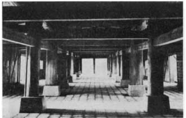
写真② 第三台場休憩所（関東大震災後の修繕）
