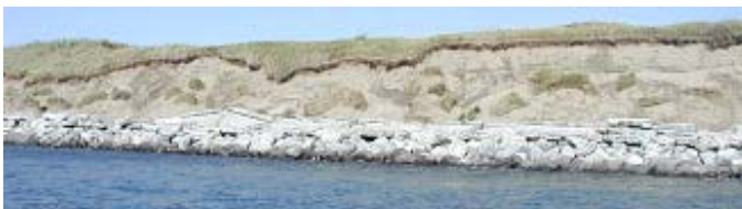
護岸崩壊部分
